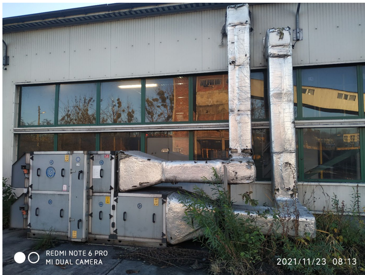
system nawiewno – wywiewny
