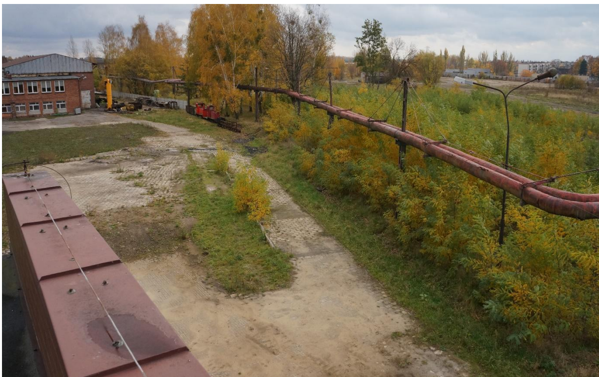
Przez nieruchomość przebiega naziemny ciepłociąg przynależny do piekarskiego MPEC
